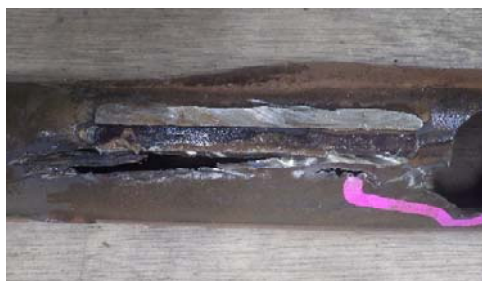
撤去したプロテクター(金物溶接部に貫通あり)
