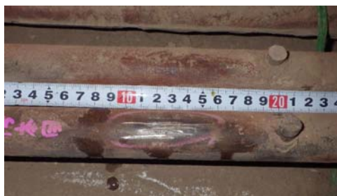
ボイラーチューブ損傷部
